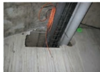
Fot. 2: Nieszczelność wewnętrzna: przepust kablowy pomiędzy sąsiadującymi ze sobą pomieszczeniami składowymi budynku (Źródło: IngBEU).
